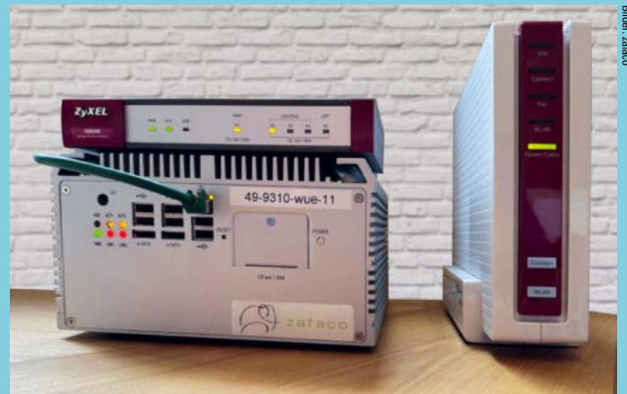
Messaufbau in Zentrale („Office“, links unten) und Homeoffice (oben)
