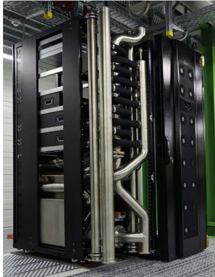
Power auf engstem Raum: über 1 MW Kühlleistung für direkte Chipkühlung mit Wasser
